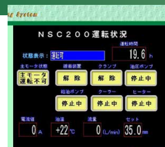
タッチパネルで運転確認
