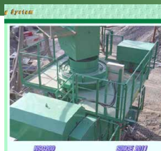
カメラで運転状況確認
