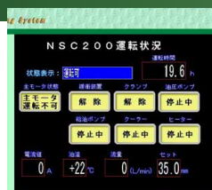
タッチパネルで運転確認
